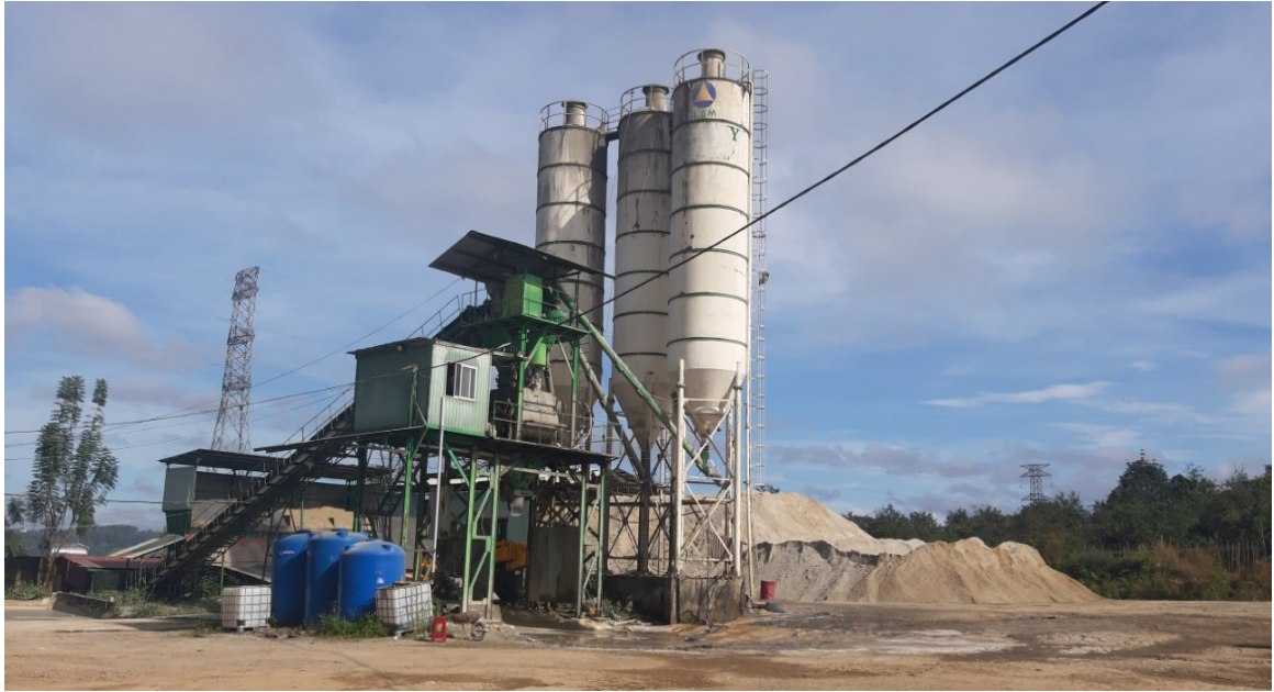
Hình 1.13: Trạm trộn bê tông thương phẩm tại tỉnh Đắk Nông
