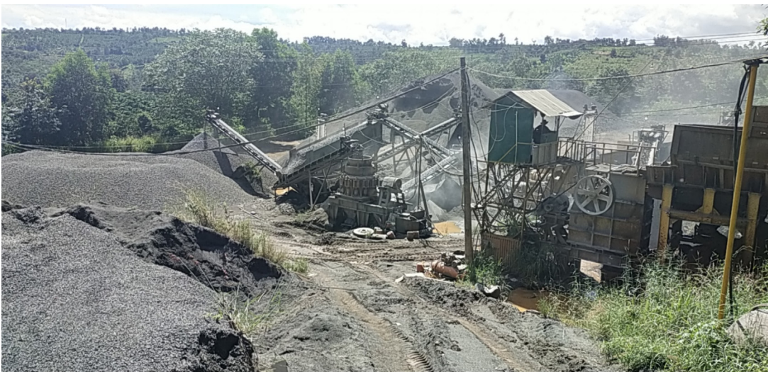
Hình 1.10: Dây chuyền nghiền đá xây dựng
